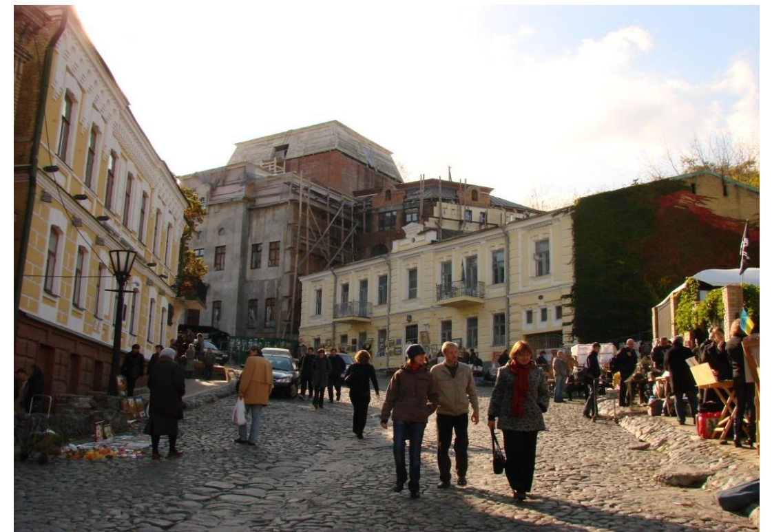
Реставрація забудови з реконструкцією інженерних мереж Андріївського узвозу у Києві. (у процесі реалізації);
