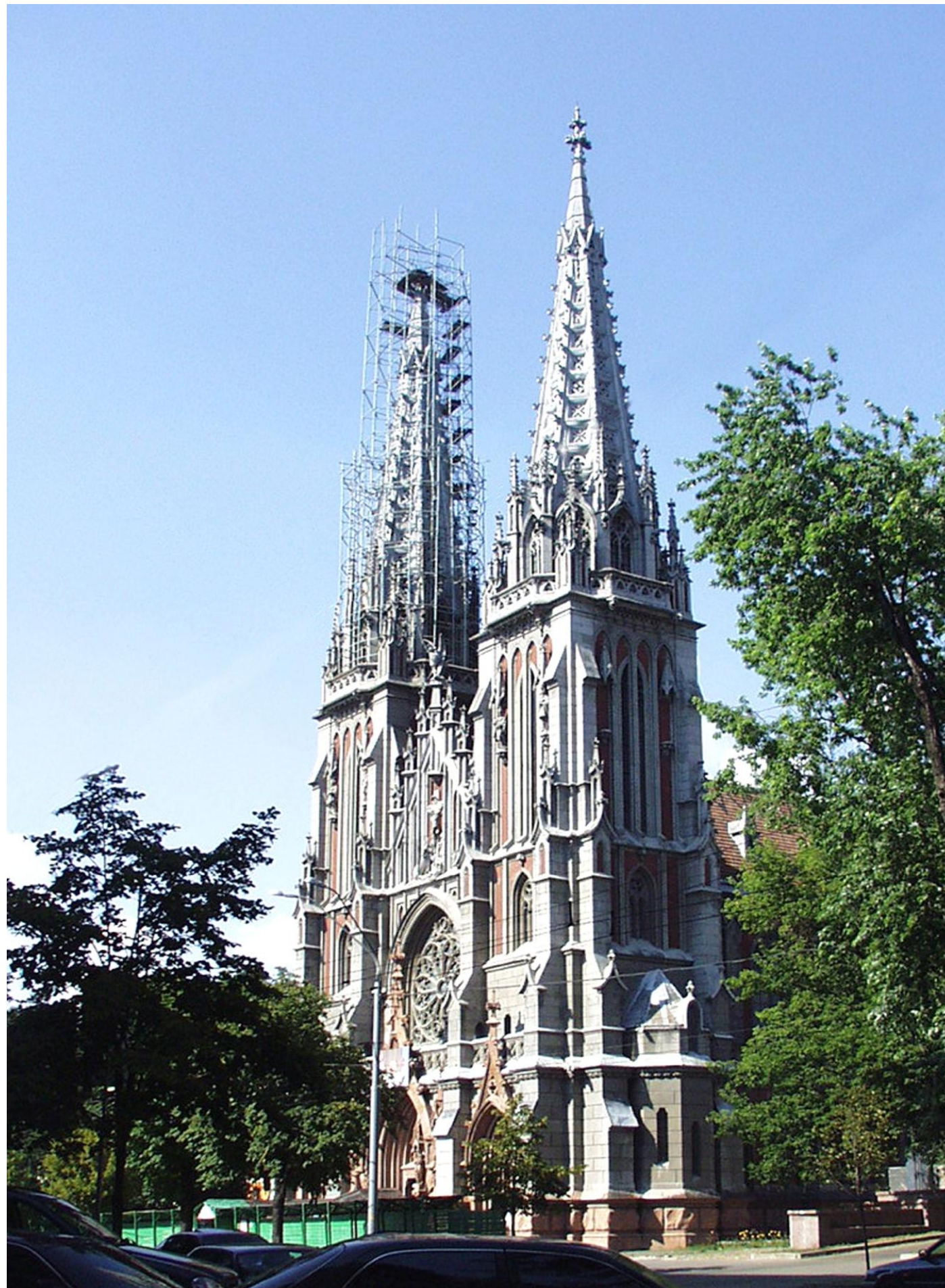
Противарійні та реставраційні роботи по Микільському костьолу (Будинку органної музики) у Києві (у процесі реалізації);
